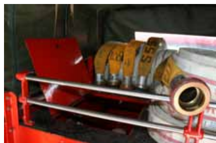
リア側からポンプ室に入っでの点検も可能。
